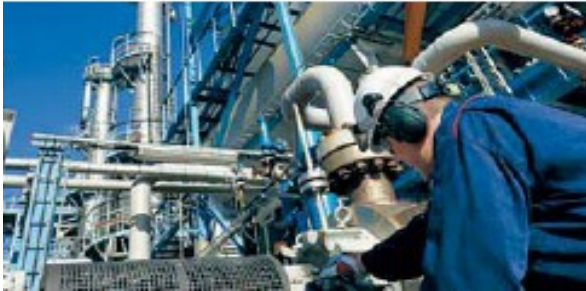
Μηχανολογικές και βιομηχανικές εγκαταστάσεις
